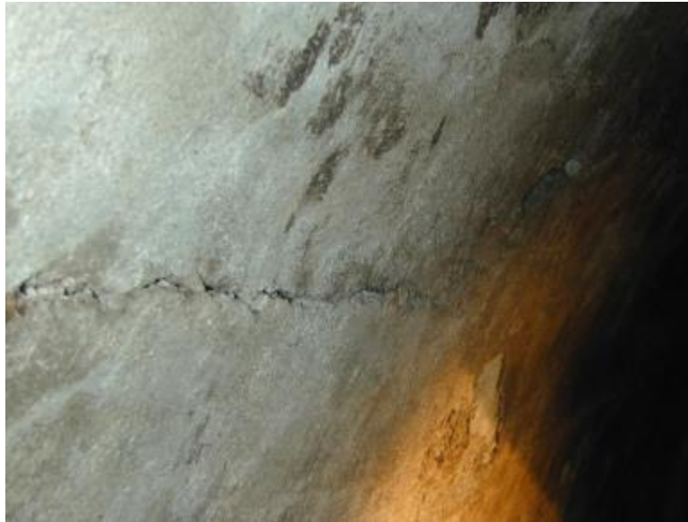
5.5a) ábra Beton szennyvízcső sérülései (2050:2750) (Befogadócső állapot II és III)
