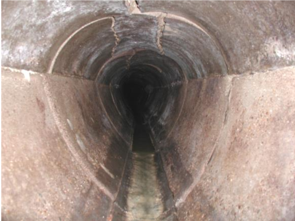
1.3 ábra Tojásszelvényű beton szennyvízcsatorna (700/1050) nagymértékű deformitás, szennyvízcsatorna → HPS III nem járható!!!
