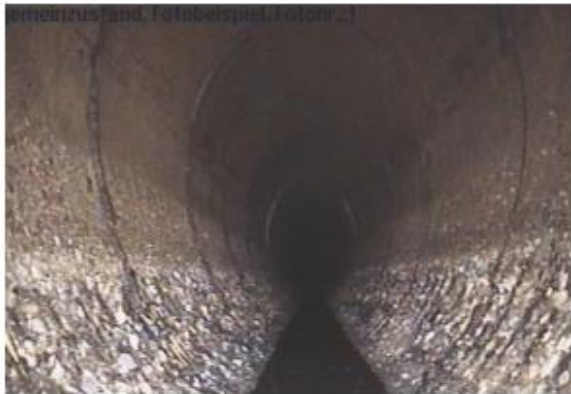
1.9 ábra: Vasbeton csatorna, beton- és betonvas korróziója → HPS I?
