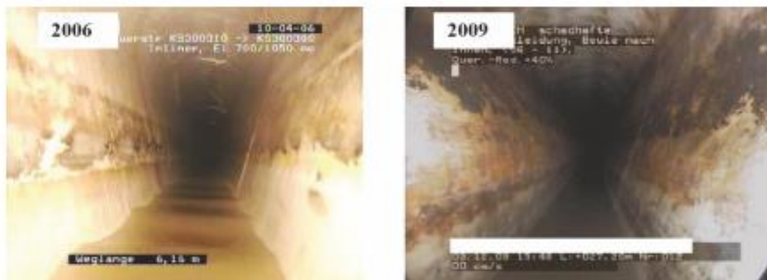
4.3 ábra: CIPP tojásszelvény csatorna kúszásos behorpadása (SZ:M=700:1050), terhelés: h_w = 2 m talajvíz oszlop a boltozat tetőpontja fölött
