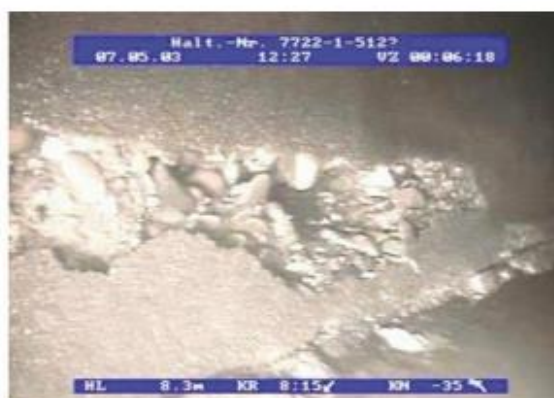
1.6 ábra: Csőfal részleges hiánya, beton minőség < C8/10! → HPS IIIa
