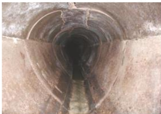
1.3 ábra: Tojásszelvényű beton szennyvízcsatorna B/H = 700/1050 mm, nagymértékű deformitás, a csatornába tilos bemenni!!! → HPS III
