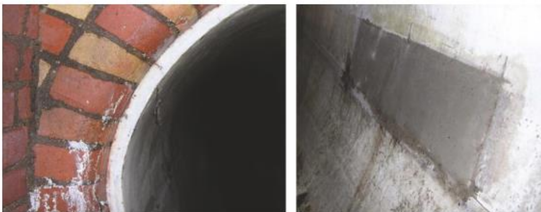
2.5 ábra: Gyűrűs hézag mérése, tojásszelvény, baloldalt: Akna melletti rész (a mérés nem megfelelő), jobboldalt: Próbakivágással (megfelelő)
