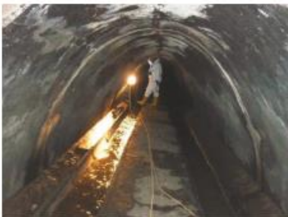
5.8a) ábra Parabola szelvény SZ:M = 2350:1970 mm, repedés a boltozaton
