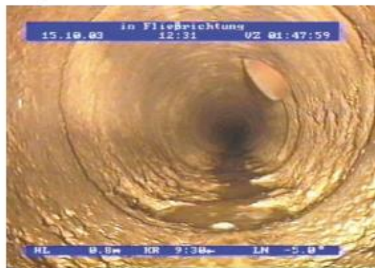
1.4 ábra: Korrozó a csatornafalban HPS I (IIIa?)
