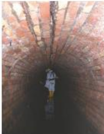
5.6a) ábra Tojás profilú falazott gyűjtőcsatorna SZ:M=1200:1800 mm, nyitott repedés a boltozaton
